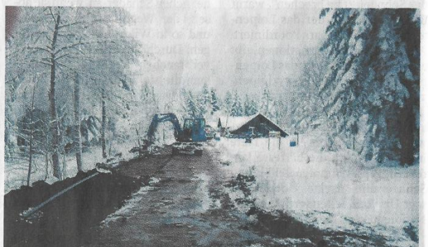
Auf den ersten Blick sieht es noch wüst aus auf der Nachtloipe bei der Skihütte Kniebis. Aber das täuscht. Die Loipe umfährt die Baustelle problemlos.
